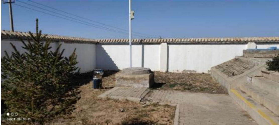
张记梁蓄水池阀井现状
