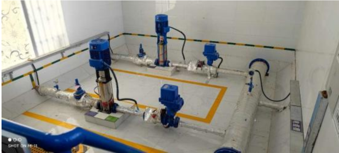
李记沟一泵站机组现状
