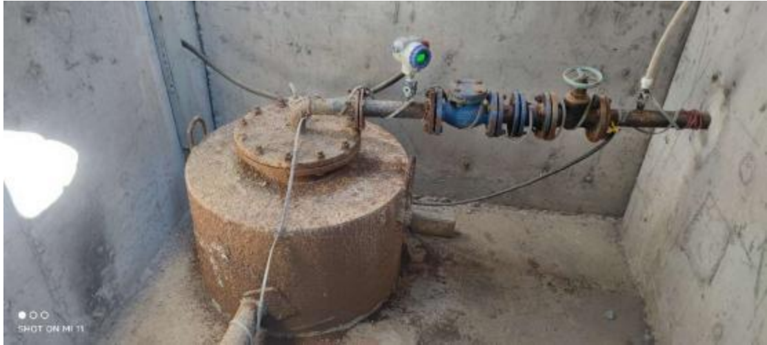
关记沟泵站潜水泵现状
