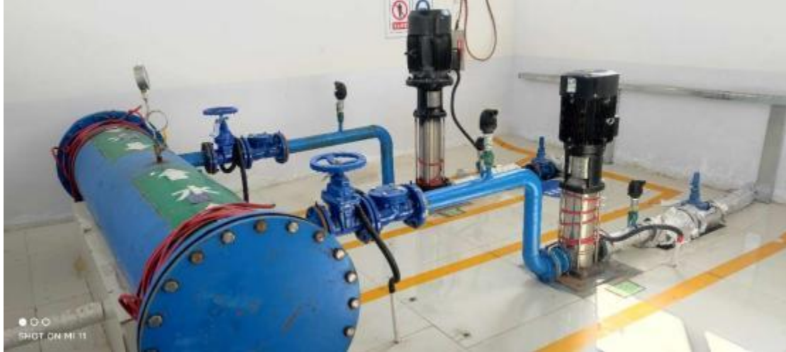
杨寨子泵站 3#、4#机组现状
