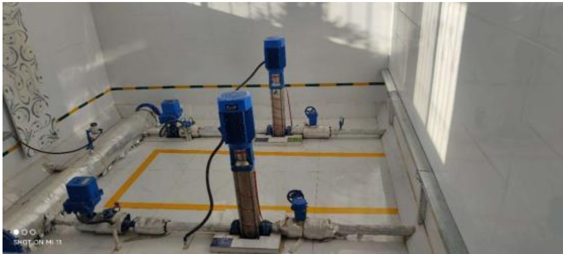
李记沟二泵站机组现状
