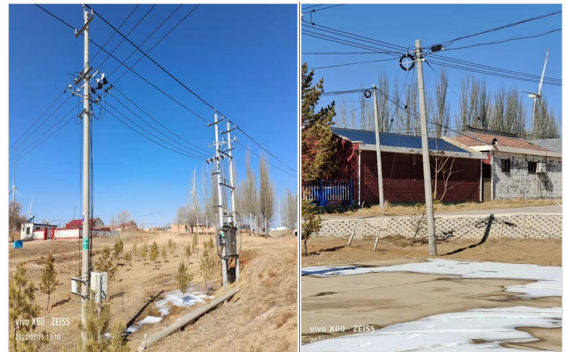
图 2-13 电力设施现状情况
