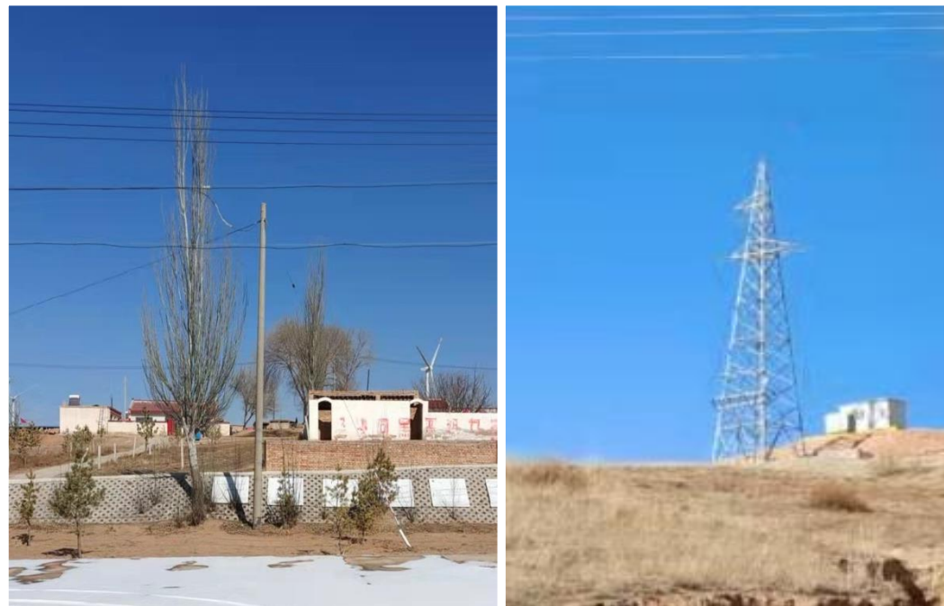
图 2-14 通信设施现状情况
