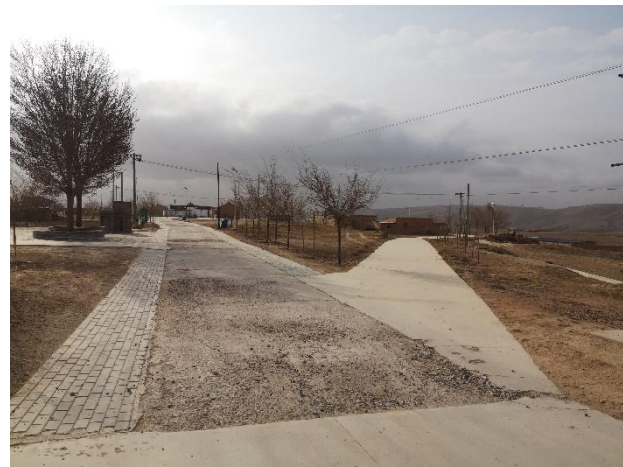
图 2.4.2 硬化破损路面
