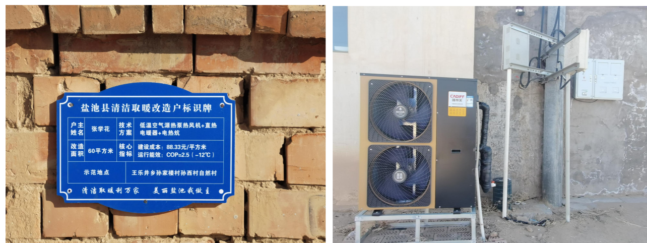
图 2-5-13 清洁取暖改造设施
