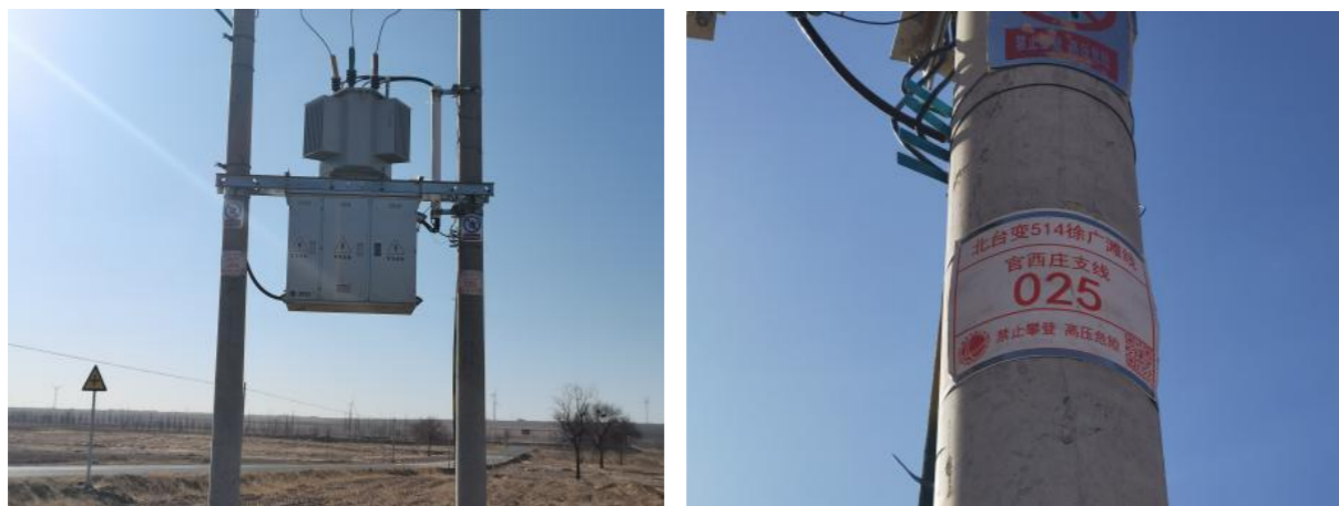
图 2-5-11 孙家楼村变压器
