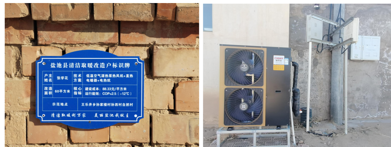
图 2-5-13 清洁取暖改造设施
