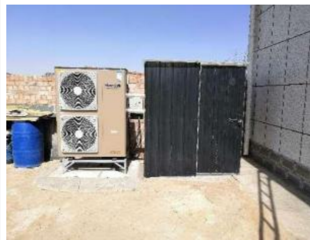
图 6.1.5 空气能使用现场照
