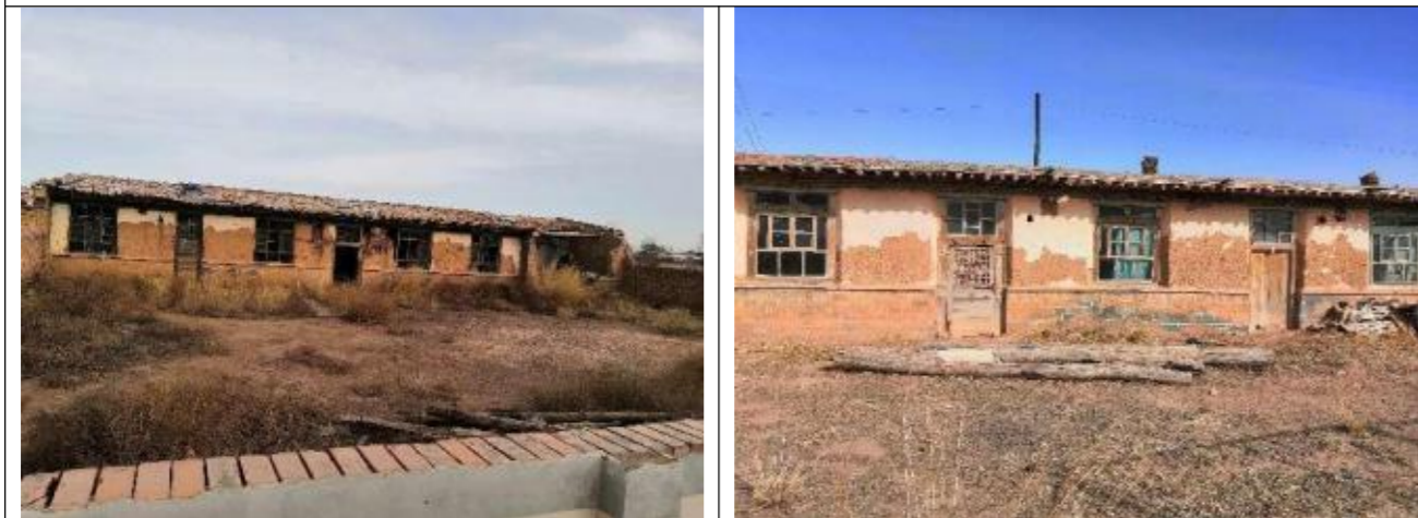
图 2.10.3 建筑质量较差房屋
