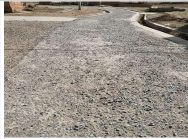
图 2.5.6 南洼村庄内部道路(破损)
