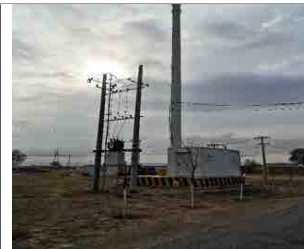
图2-14电力电信设施
