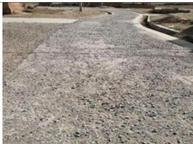
图2-13南洼村庄内部道路(破损)
